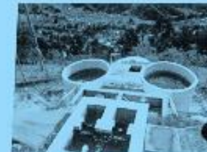
Cajón recolector y filtros
